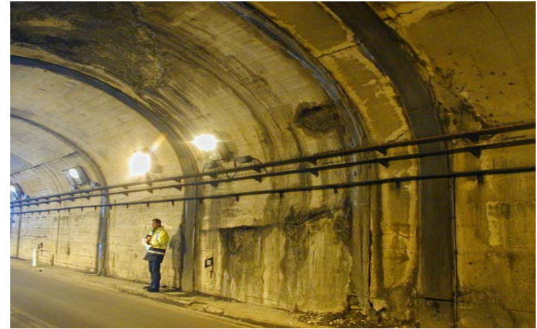
LONGUEUR DEGRADEE / LONGITUD DETERIORADA
