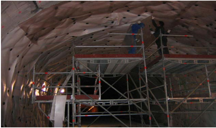
REALISATION D'UNE ETANCHEITE SUR TOUTE LA SURFACE DE LA ZONE REPAREE REALIZACION DE TRABAJOS DE IMPERMEABILIDAD SOBRE LA SUPERFICIE DE LA ZONA DETERIORADA
