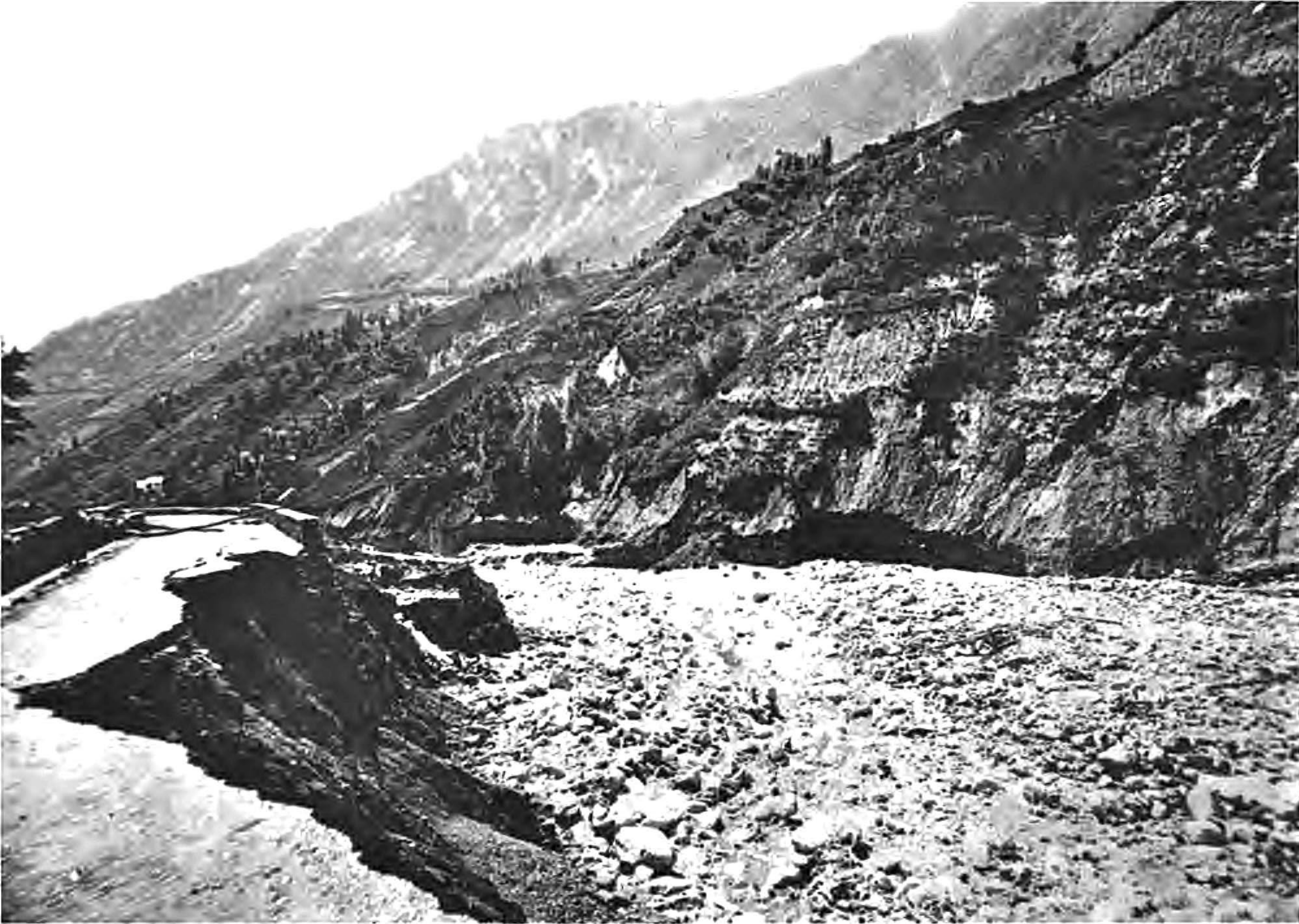
X. — LA CRUE DE 1897 — A DROITE, LE VERSANT DES ARTIGALAS ET L'EMPLACEMENT DE LA DIGUE DÉTRUITE. A GAUCHE, LA ROUTE THERMALE, ENTRE BARÈGES ET LA MAISON FORESTIÈRE.
